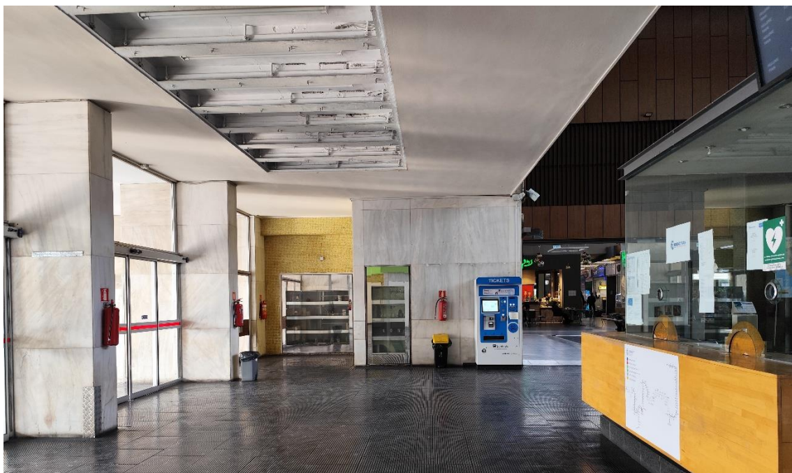
Εικ. 8: Εσωτερική άποψη του χώρου εισόδου με χαμηλό ύψος. Εντοπίζονται οι φθορές στην ορθομαρμάρωση, η έλλειψη ψευδοροφής σε συγκεκριμένο σημείο, οι φθορές στα φωτιστικά σώματα και οι ασύμβατες κατασκευές στο βάθος (επένδυση με κίτρινες ψηφίδες). Πηγή: Φωτογραφική αποτύπωση.
