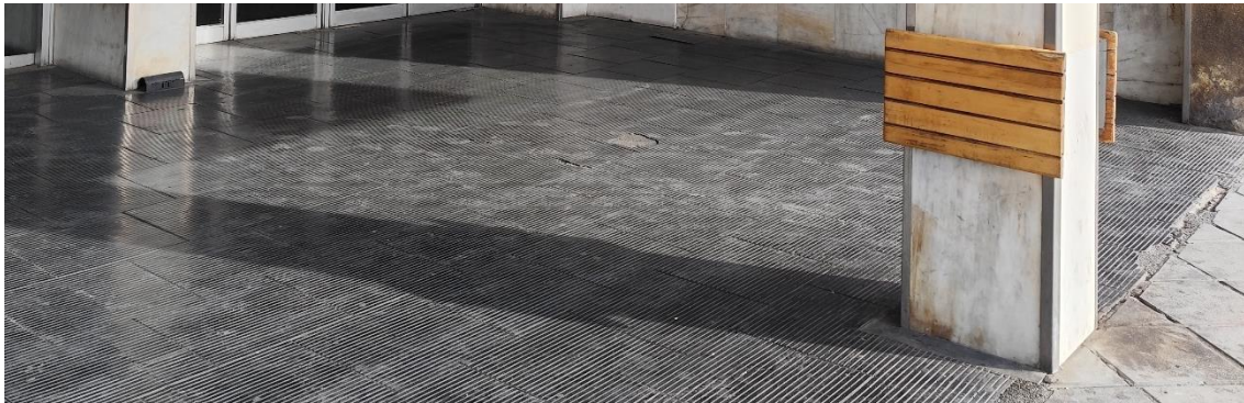
Εικ. 6: Φθορές σε βινυλικό δάπεδο και ξύλινα προστατευτικά στοιχεία – χειρολαβές. Πηγή: Φωτογραφική αποτύπωση.
