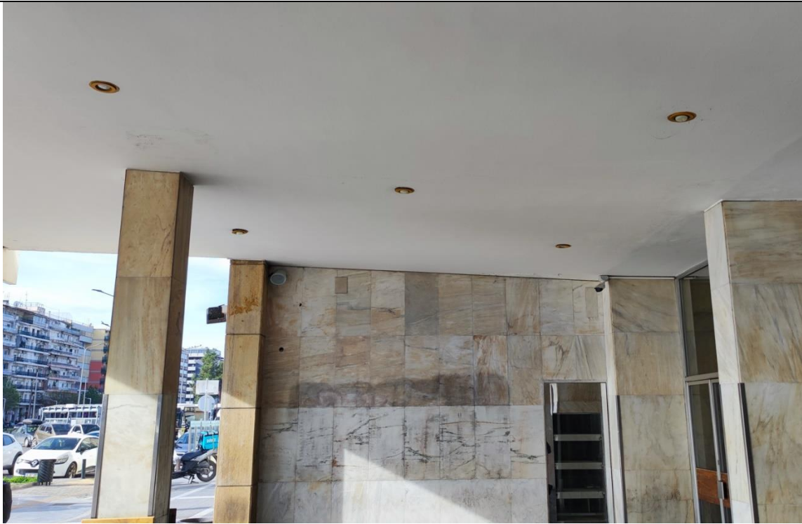
Εικ. 5: Φθορές σε μαρμάρινες επενδύσεις και οροφή ημιυπαίθριου. Πηγή: Φωτογραφική αποτύπωση.
